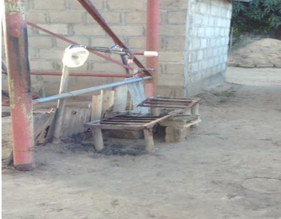
Figura 21 Fontanário privado de um PFA - Bairro Bagamoio Cidade de Maputo
