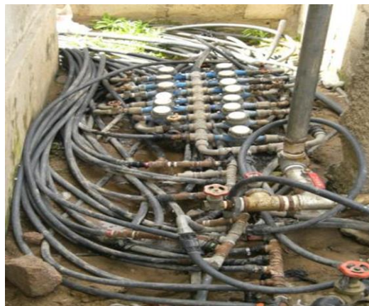
Figura 18 Bateria de contadores dos FPA'
