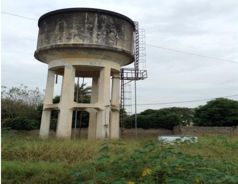
Figura 12 Depósito elevado do Sistema Público da vila de Marracuene
