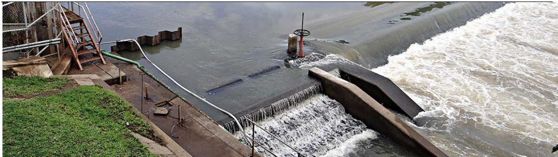
Figura 2: Sistema de captação com bombas horizontais
