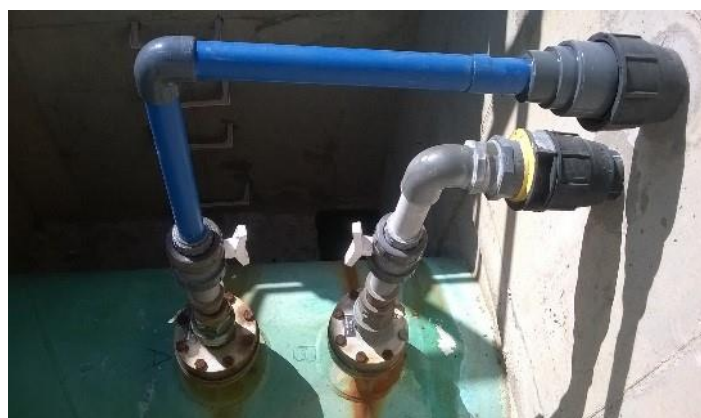
Figura 4: Injecção do cloro na conduta de água bruta (pré-cloração)
