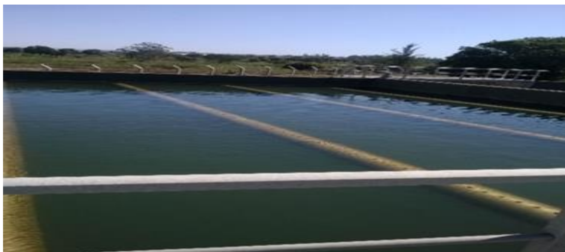
Figura 8: Decantadores rectangulares (ETA 3)
