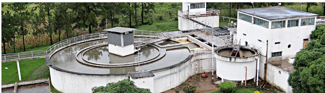
Figura 7: Decantadores circulares (ETA 1)
