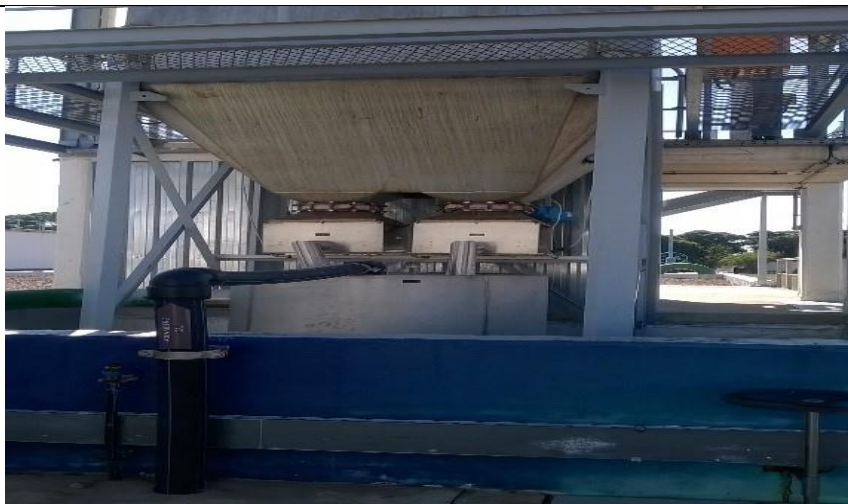
Figura 10: Sistema de doseamento da cal para a correcção do pH
