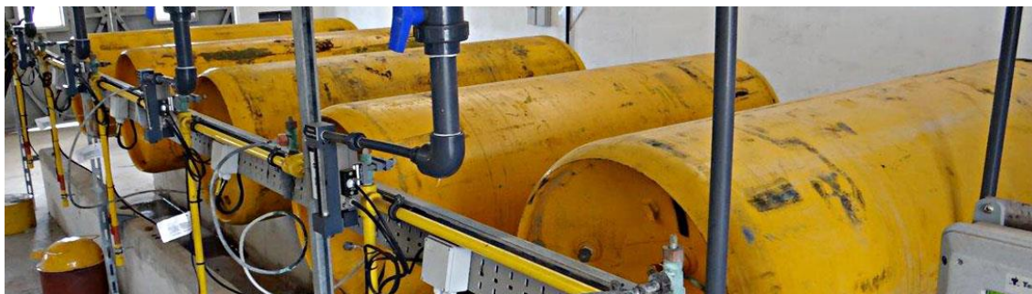
Figura 11: Sistema de doseamento do cloro gasoso (pós-cloração)
