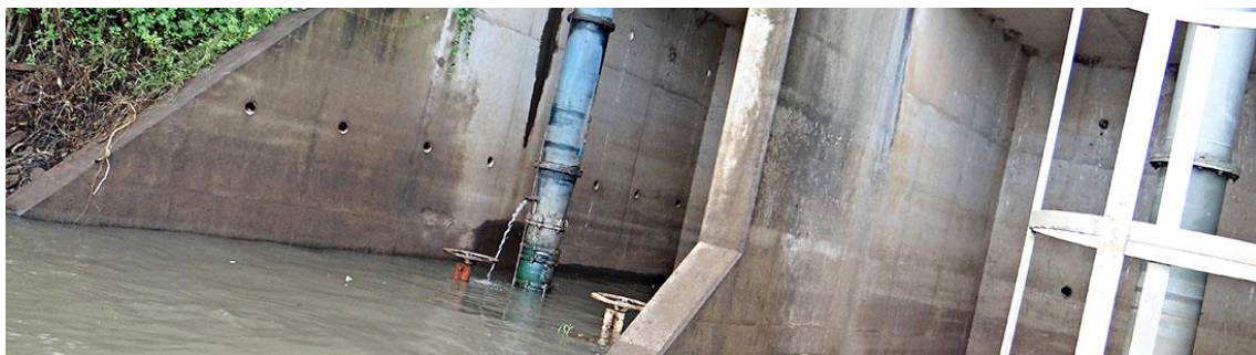
Figura 3: Sistema de captação com bombas verticais
