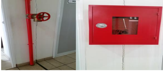
Foto 21: Composição do sistema hidráulico instalado no edifício da DPEDHM Fonte: autor
