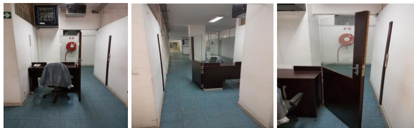
Foto 10: Imagem de uma rota de fuga obstruída Fonte: autor
