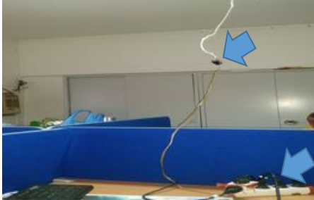
Foto 2: Presença de uma fonte de perigo de natureza eléctrica num dos Gabinetes do edifício anexo Fonte: autor
