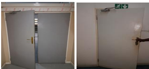
Foto 11: Imagens ilustrativas de portas abrindo no sentido oposto ao da evacuação com molas hidráulicas Fonte: autor
