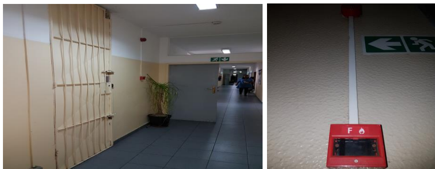
Foto 15: Imagem ilustrativa de detectores ópticos de fumos e de um Sistema de alarme contra incêndios fora de uso Fonte: autor
