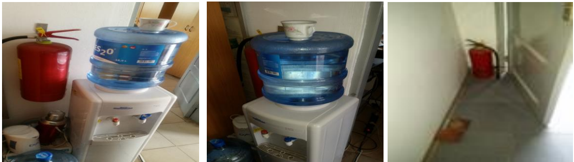
Foto 19: imagens ilustrativas de extintores mal implantados Fonte: autor
