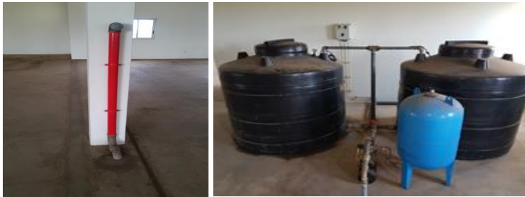
Foto 22: Imagens ilustrativas de uma parte do sistema hidráulico instalado no edifício da DPEDHM Fonte: autor
