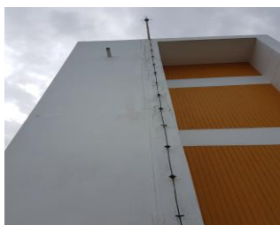
Foto 4: Imagem de um para-raio instalado no edifício do MISAU Fonte: autor
