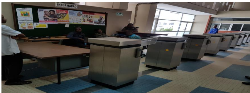
Foto 12: Equipamento montado junto à principal porta de acesso ao exterior do edifício, onde termina a única rota oficial de fuga
