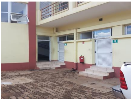
Foto 17: Imagem do extintor exposto às intempéries
