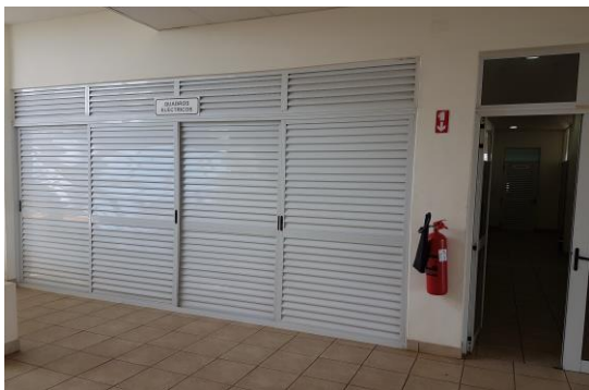
Foto 1: Um dos quadros eléctricos localizados em cada um dos pavimentos do edifício sem sinal de proibição de fumar ou de foguear
