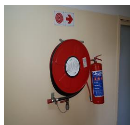
Foto 25: imagem ilustrativa Implantação de mangueiras para mangotinhos em corredores sem pontos de tomada de água Fonte: autor
